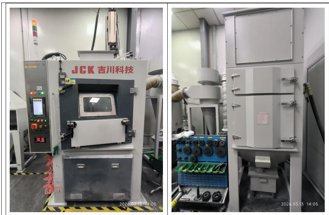
图 3-4 喷砂机及废气处理设施
