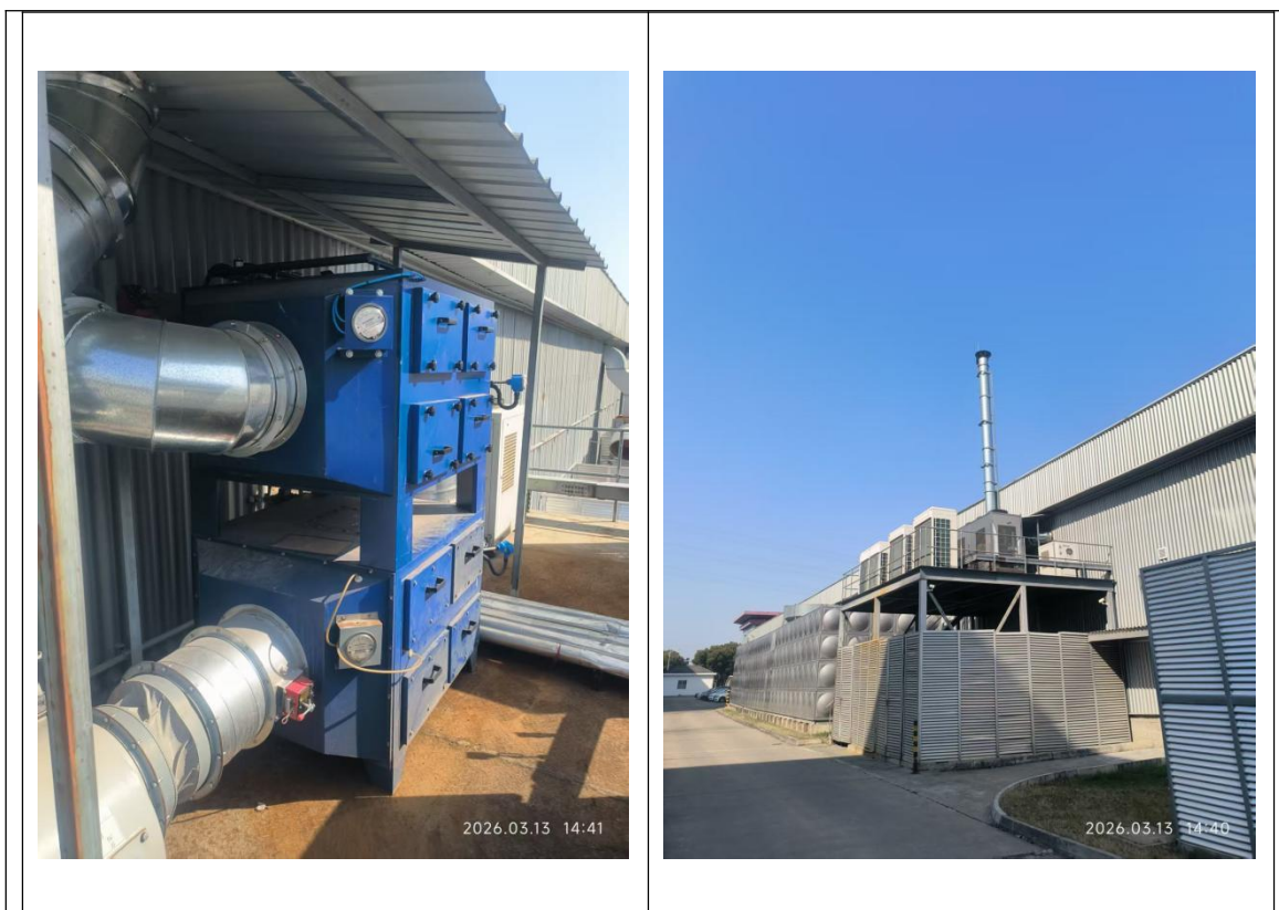
图 3-2 P8 排气筒及废气处理设施现场图片
