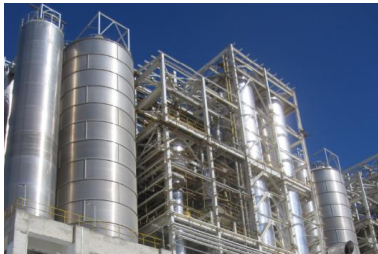
Bild 1 Anfang 2014 konnte die schlüsselfertige Anlage an EIPET übergeben werden.
